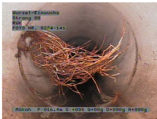
Wurzeleinwuchs ist nur einer von vielen möglichen Schäden im Abwassernetz.
